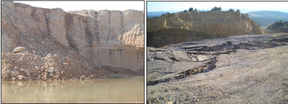
Figura 12. Grietas verticales y desprendimientos en una gravera (izquierda). Grietas de tracción en cabecera de un talud de una explotación de arcillas (derecha)
